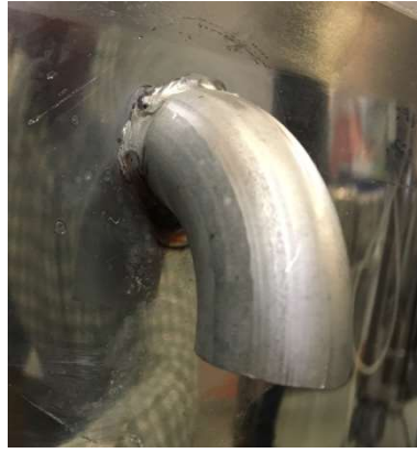
Bild 3. Auffüllungsrohr für Heizwasser
